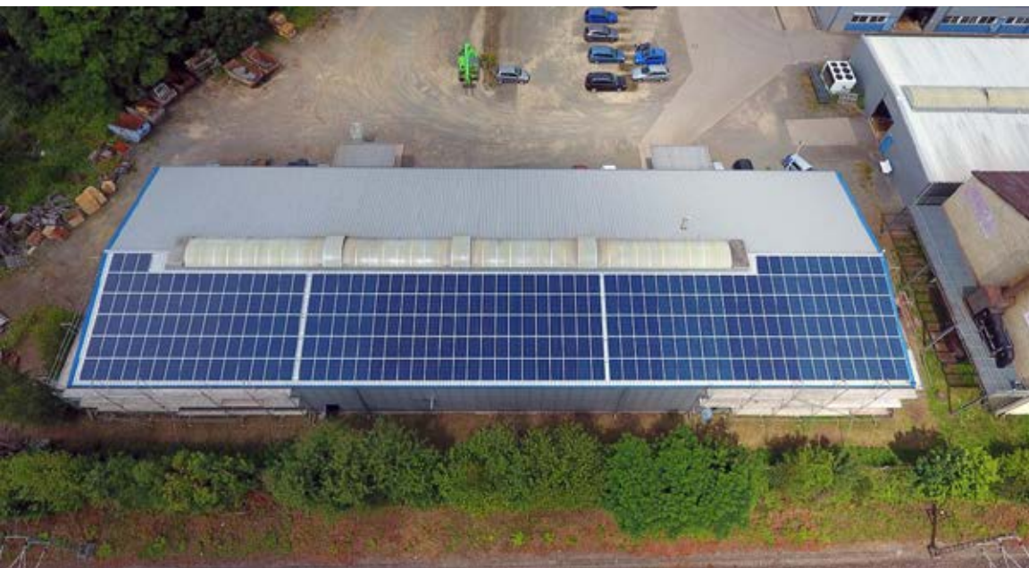
Abb. 23: Aufdachanlage der Firma Kaus Backes GmbH (Quelle: Damm Solar GmbH).
