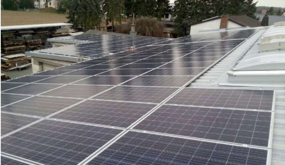
Abb. 21 (o.): Aufdachanlage der Schlosserei Neumann GmbH (Quelle: Damm Solar GmbH).
